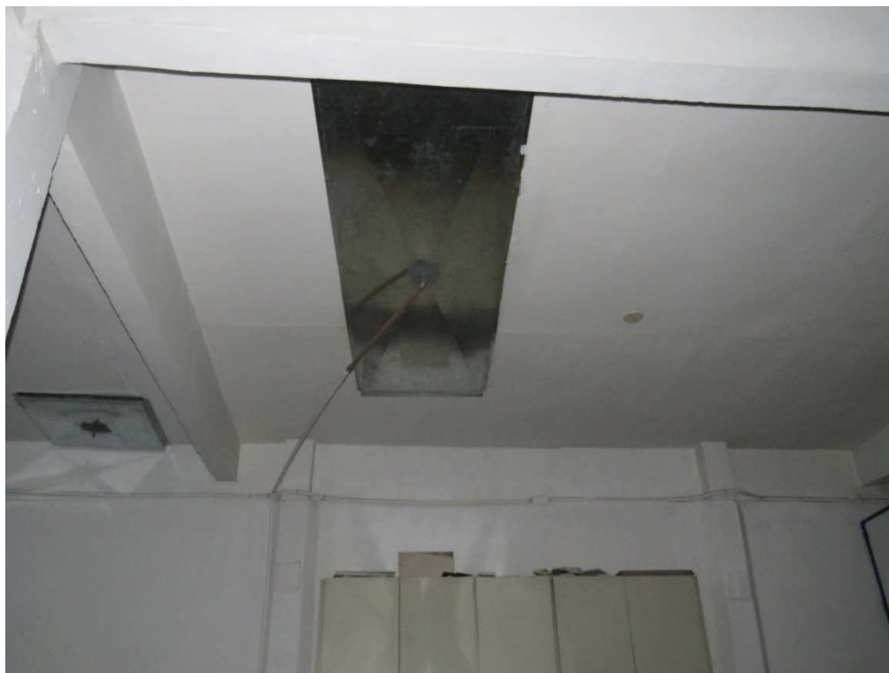
Foto 21- Calhas no teto da garagem devido a infiltrações do térreo
