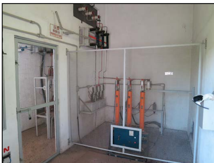
Fotos 15, 16 e 17: Vistas da cabine primária.
